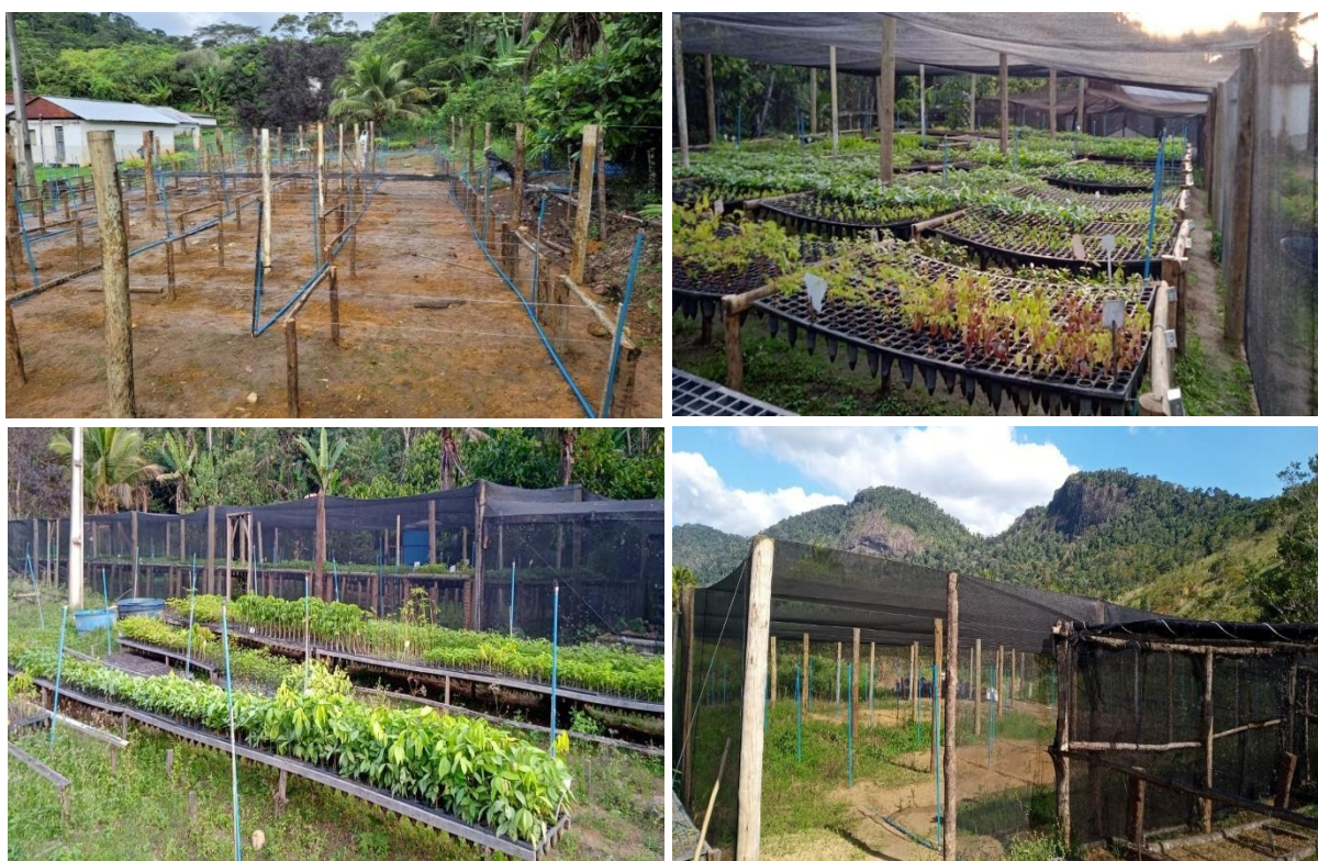
Figura 43. Imagens da reforma realizada nos dois viveiros de mudas no Núcleo Jequitibá
